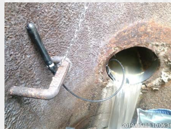
設置例: 管渠(水位チップ+エアチューブ)
